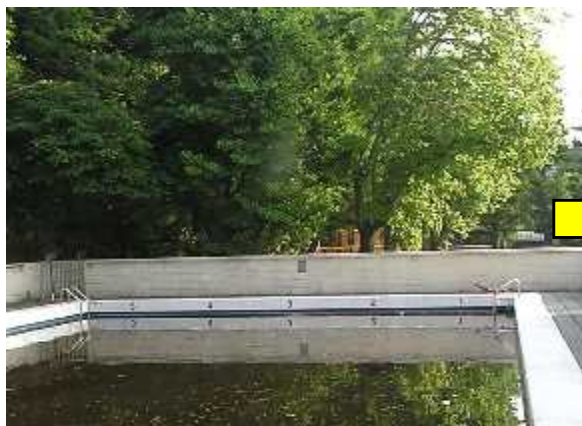
(改善前) 附属小学校ブロック塀 B
